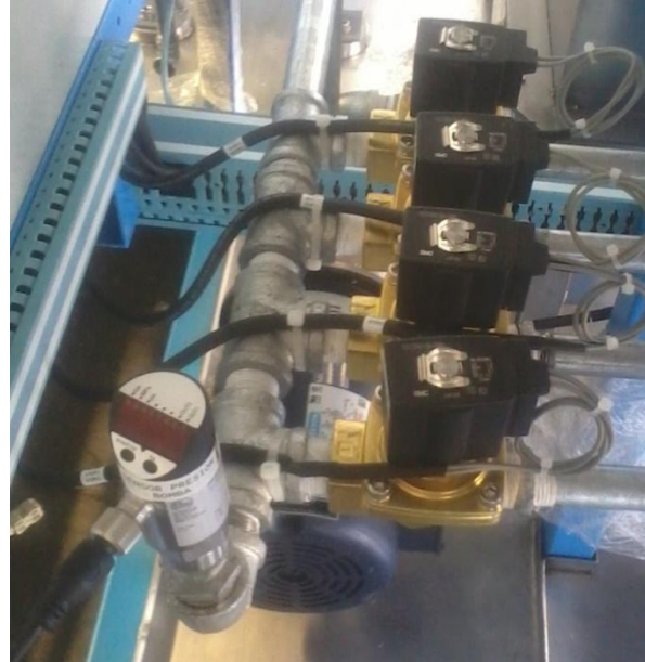
Fig. A. 21. Conexión física de electroválvulas y sensor de presión de bomba.
