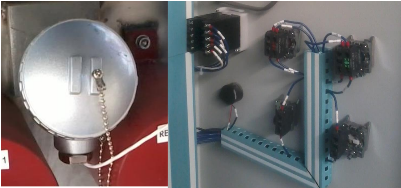
Fig. A. 14. Conexión física de Botonería, Buzzer, Pirómetro y Sensor de Temperatura. La conexión del pirómetro se conectó de acuerdo el manual de operación y en conjunto con el programador.
