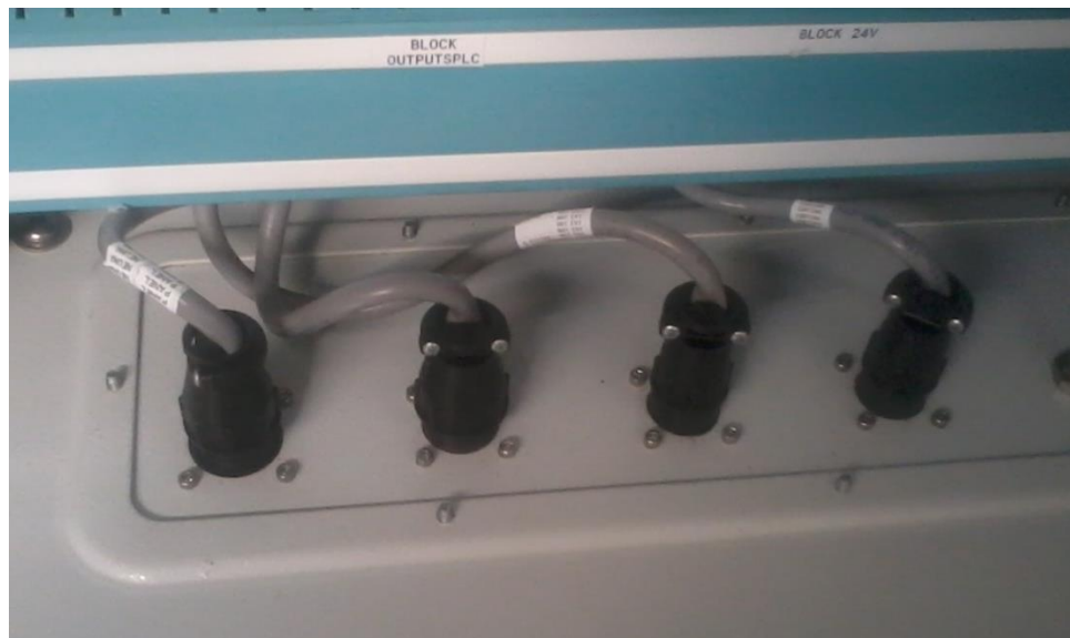
Fig. A. 19. Estas conexiones se implementaron para evitar cortos circuitos, conexiones equivocadas en salidas o entradas del PLC y el ruteado ideal del cableado reduciendo el espacio utilizado.
