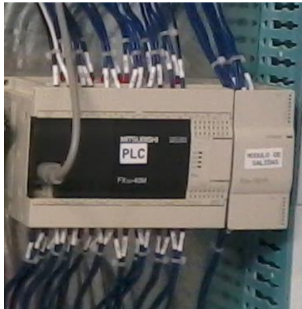
Fig. A. 10. Conexión física del PLC Mitsubishi y Modulo de Salidas Mitsubishi. Durante la conexión del PLC se nos presentó una problemática de un faltante considerable de salidas del PLC. Por lo anterior se solucionó el problema con la compra de un módulo de 14 salidas.
