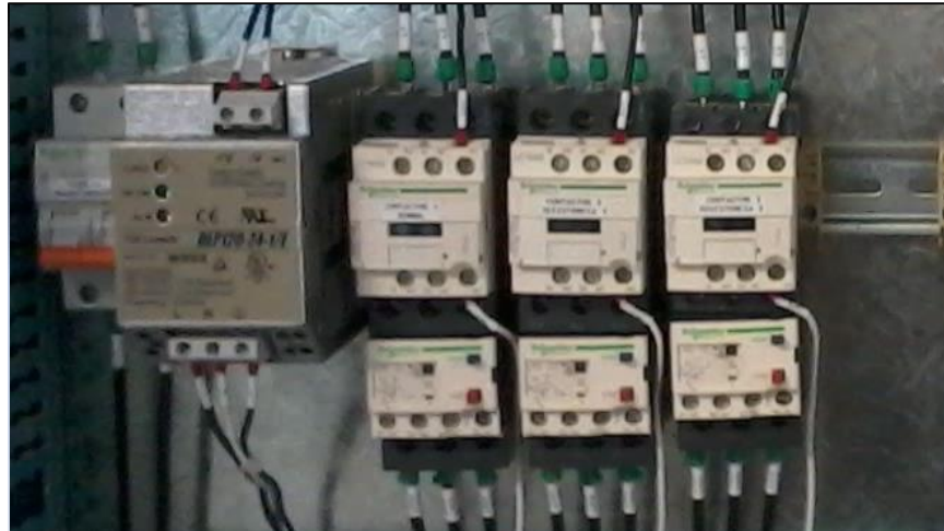
Fig. A. 4. Conexión física de Interruptor térmico del transformador, Fuente TDK 24VDC y Contactores de Bomba y Resistencias 1 y 2.
